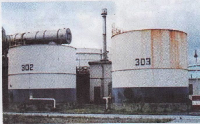
海浜部の化学プラントの防食に
